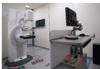
マンモグラフィー検査室
